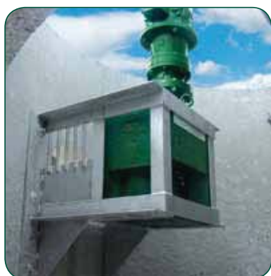
Mini Monster установленный на насосной станции
